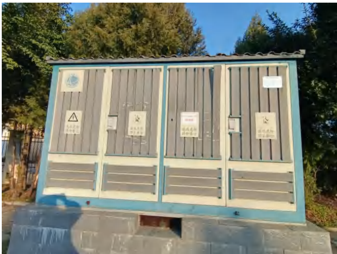
图 2.2.5-5 企业自建变电站
